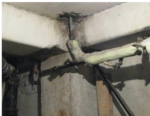
4.20.3.att. Mitruma plankumi siltummezglā pie bojāta ūdensvada
