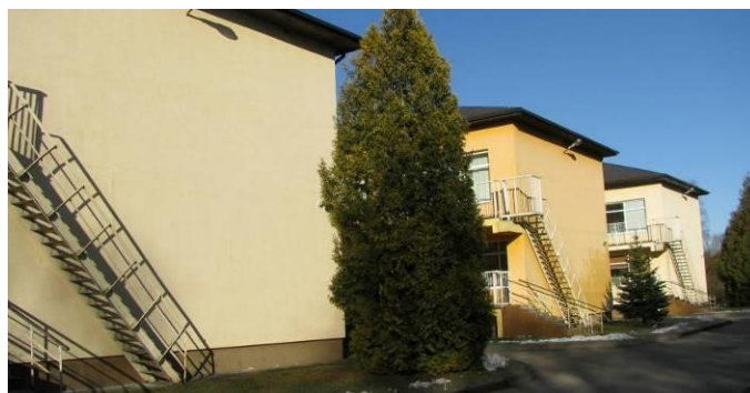
4.19.2.att. Korpusu austrumu gala fasādes. Pie kāpnēm uz vidējā korpusa fasādes redzami mitruma radīti plankumi.
