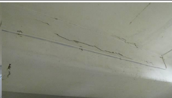
4.20.6.att. Mikroplaisas pārseguma elementu virsmā veļas mājas telpā
