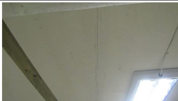
4.20.5.att. Mikroplaisas pārseguma paneļu šuvēs veļas mājas telpā.
