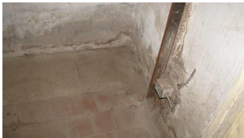
4.1.14.att. Apkopējas telpā uz grīdas mēdz sakrāties un stāvēt ūdens.
