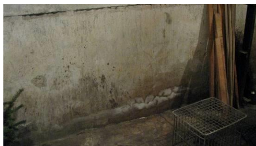
4.1.8.att. Mitruma plankums uz siltummezgla ārsienas
