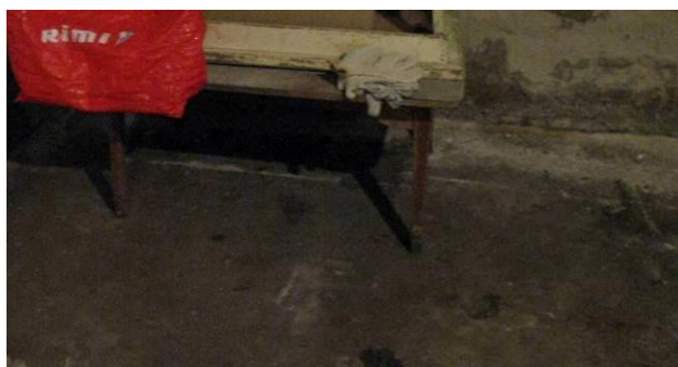
4.1.9.att. Izteikti mitruma plankumi uz grīdas gaitenī pie lifta telpas.
