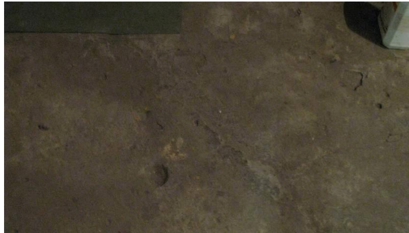
4.1.12.att. Lifta telpā uz grīdas mēdz stāvēt ūdens. Mitruma ietekmē bojātās durvis bijis jānomaina.
