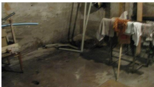
4.1.7.att. Mitruma plankums uz siltummezgla iekšējās sienas un grīdas.
