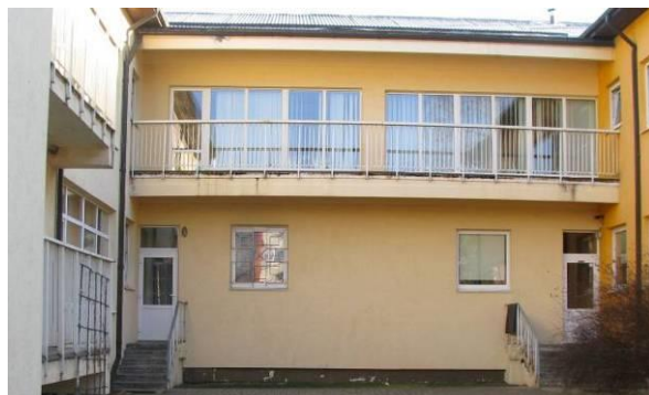
4.19.5.att. Savienojošās daļas starp 1.un 2.korpusu rietumu fasāde. Cokola apmetumā redzami krāsas izdrupumi.
