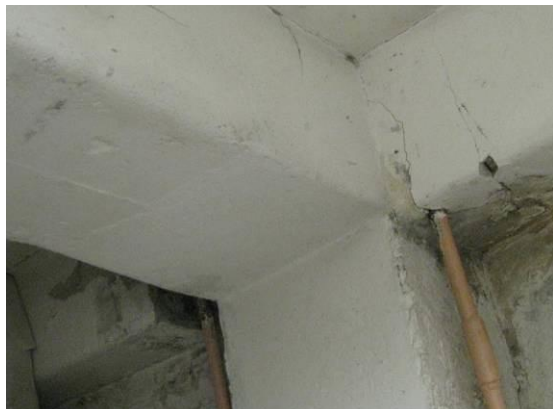
4.1.18.att. Siena mitra līdz griestiem, plaisas rīģeļa galā.
