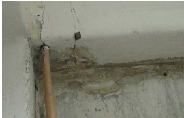
4.1.19.att. Siena mitra līdz griestiem, plaisas rīģeļa galā ar atsegtu stiegrojumu
