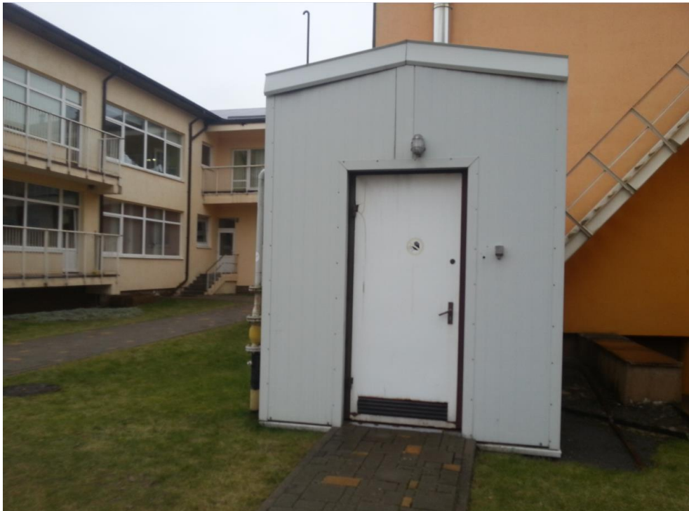
Ka siltuma avots tiek izmantota konteinera tipa katlumāja ar gāzes katlu.
