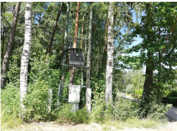
Fotofiksācija. 20/0,4 kV transformatora apakšstacija T-0646 (Meža ielas un Sila ielas krustojuma teritorijā)
